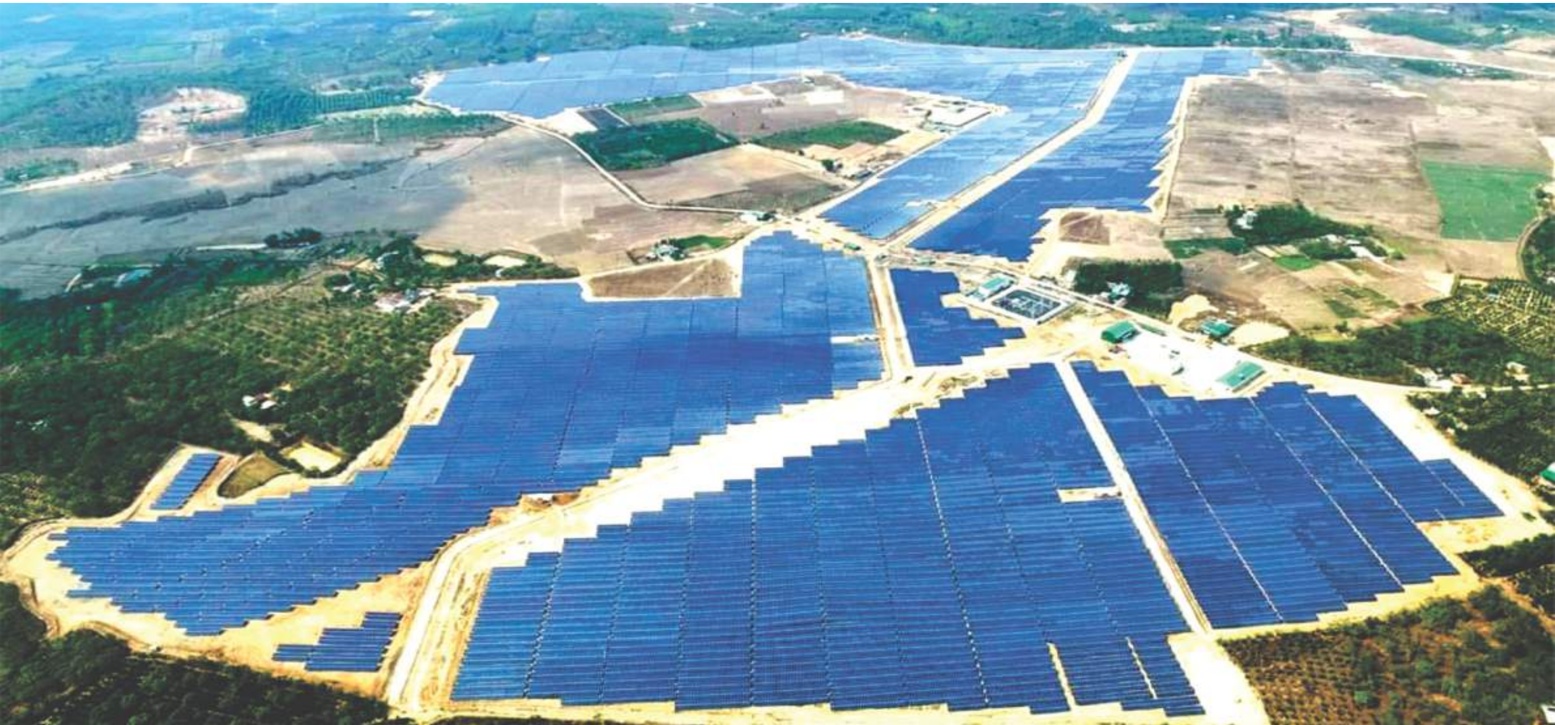
Toàn cảnh Nhà máy Điện mặt trời Cư Jút - Tại tỉnh Đắk Nông
