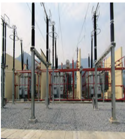
Trạm biến áp 500kV Lai Châu
