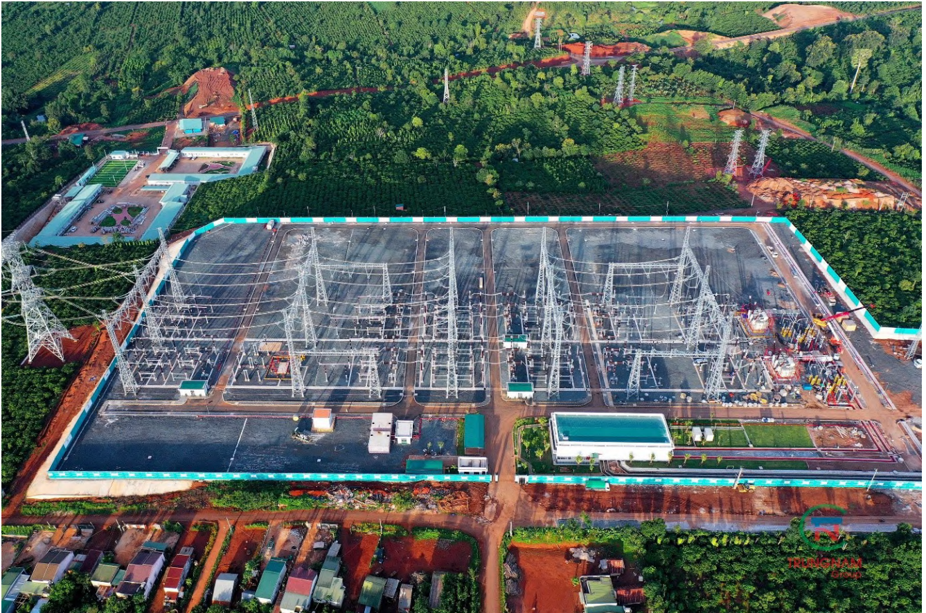
Trạm biến áp 500kV Trung Nam Thuận Nam
