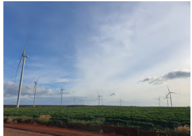
Điện gió Ia Pét – Đắk Đoa 1,2 (200 MW)
