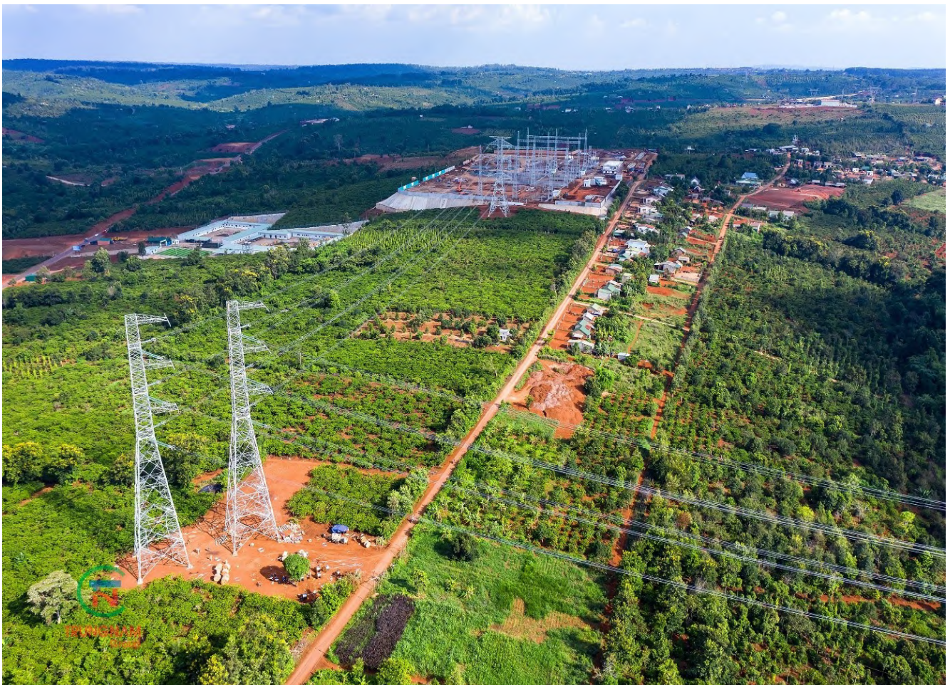
Đường dây 220/500kV đấu nối nhà máy điện gió EaNam vào hệ thống điện quốc gia
