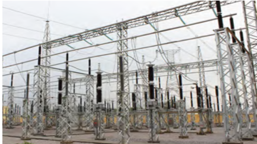
TBA 500kV Việt Trì
