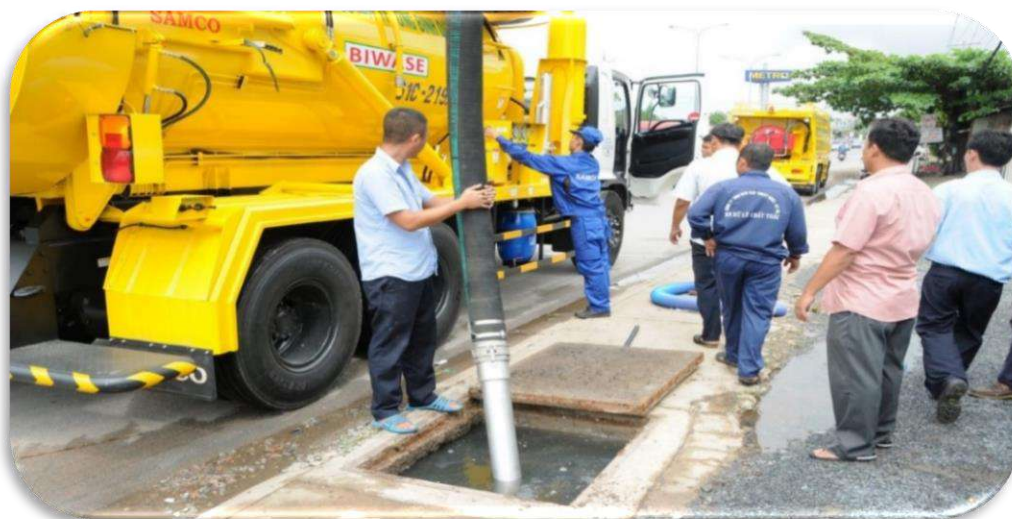
Công việc thi công rửa cống thoát nước và nạo vét hố ga bằng phương tiện, thiết bị cơ giới
