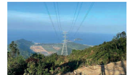
Đường dây 500kV mạch 3 đoạn Quảng Trạch - Dốc Sỏi
