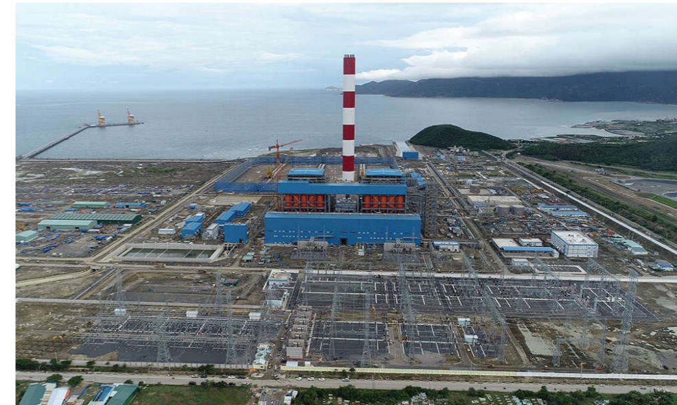
Trạm biến áp 500kV Vân Phong và đấu nối được đóng điện sẵn sàng phục vụ vận hành thử nghiệm Nhà máy Nhiệt điện BOT Vân Phong 1
