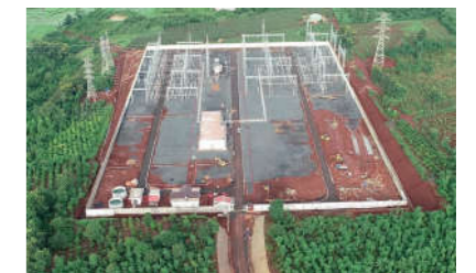
TBA 220kV Chu Sè và đường dây đối nối
