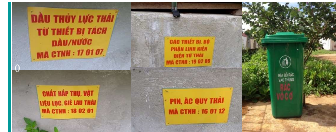
Một số hình ảnh về Bể chứa chất thải nguy hại tại các NMTĐ Thùng chứa chất thải sinh hoạt tại nhà QL VH
