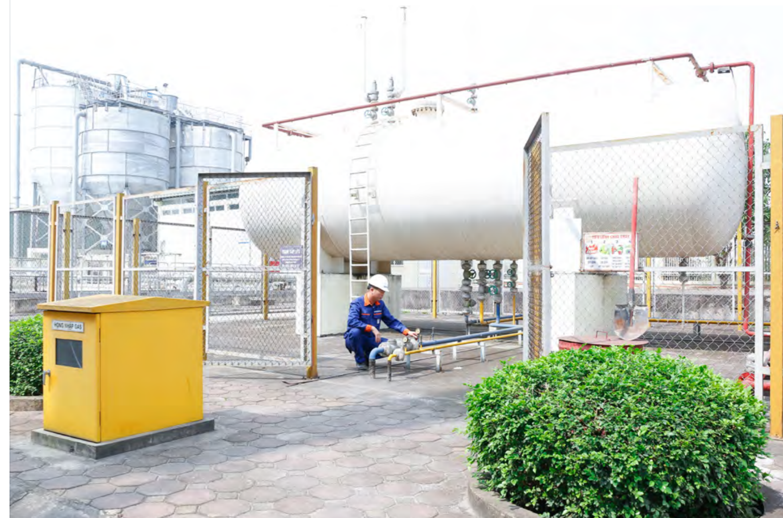
Hệ thống cấp gas được cán bộ kỹ thuật kiểm tra định kỳ nhằm đảm bảo an toàn trong quá trình cấp gas.
