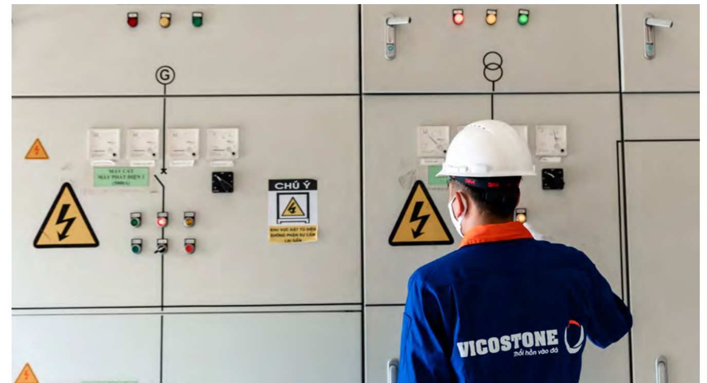
Kĩ sư điện định kỳ kiểm tra hệ thống quản lí điện của Công ty để theo dõi và đảm bảo an toàn điện
