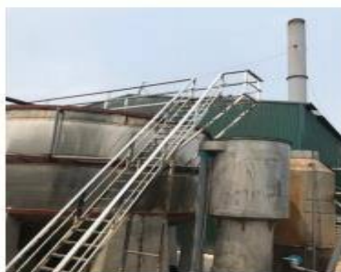
Hệ thống xử lý nước thải và nổi hơi
