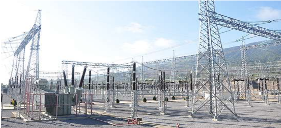
Trạm biến áp 500kV Sơn La
