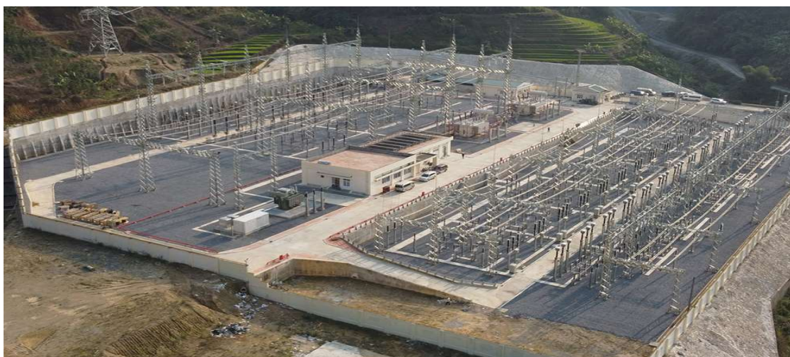
Trạm biến áp 220kV Mường Tè
