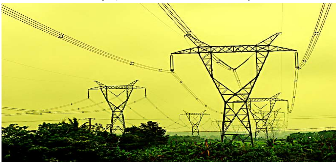
Đường dây 500kV Bắc – Nam (mạch 1)
