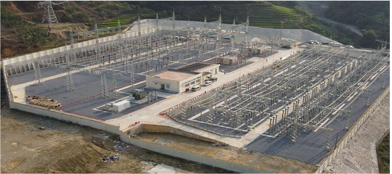
Trạm biến áp 220kV Mường Tè
