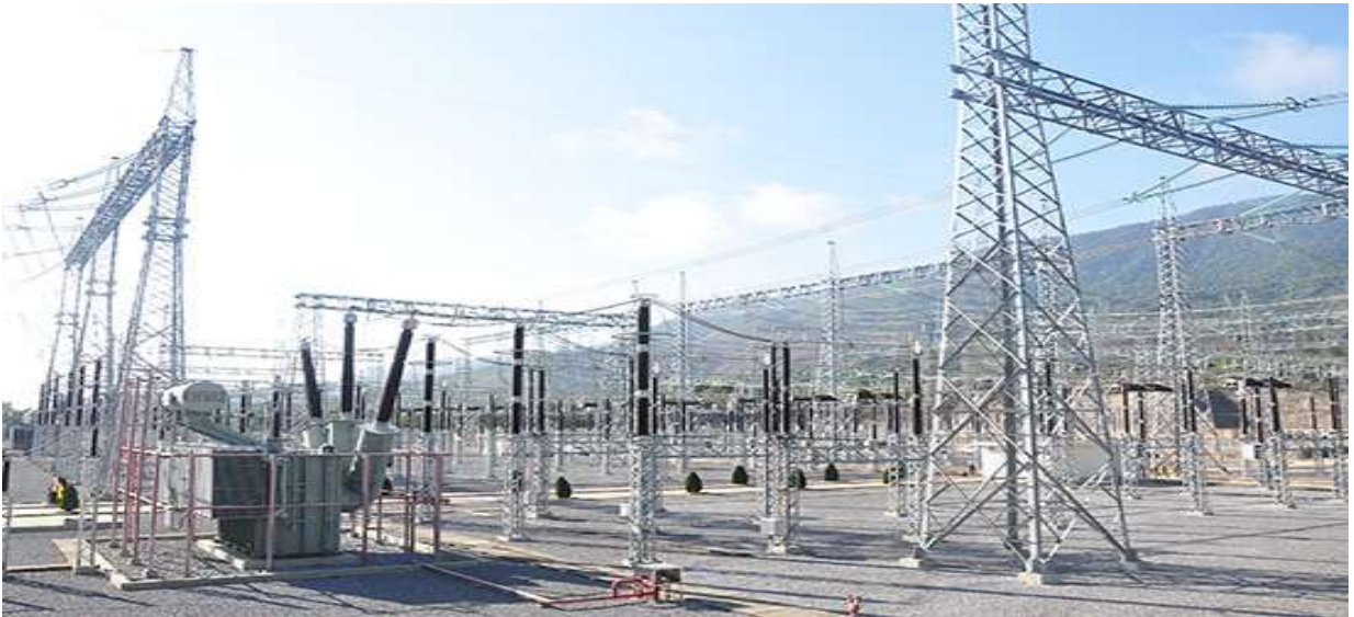
Trạm biến áp 500kV Sơn La
