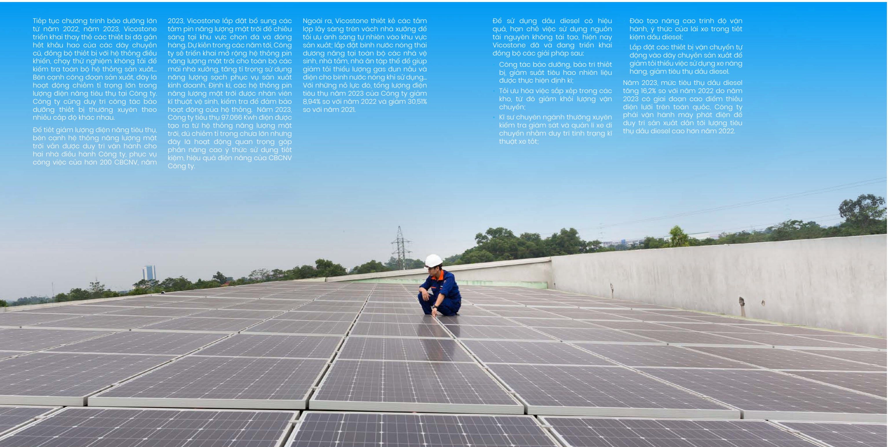
Hệ thống điện năng lượng mặt trời tại Công ty
