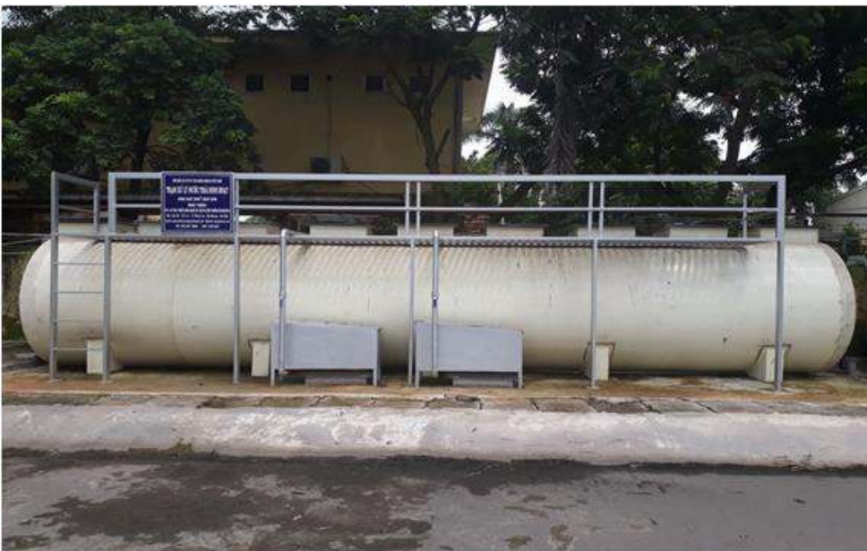
Hình ảnh: Hệ thống xử lý nước thải công suất 30 m 3 /ngày.đêm tại 3 nhà máy thức ăn chăn nuôi KCN Khắc Niệm
