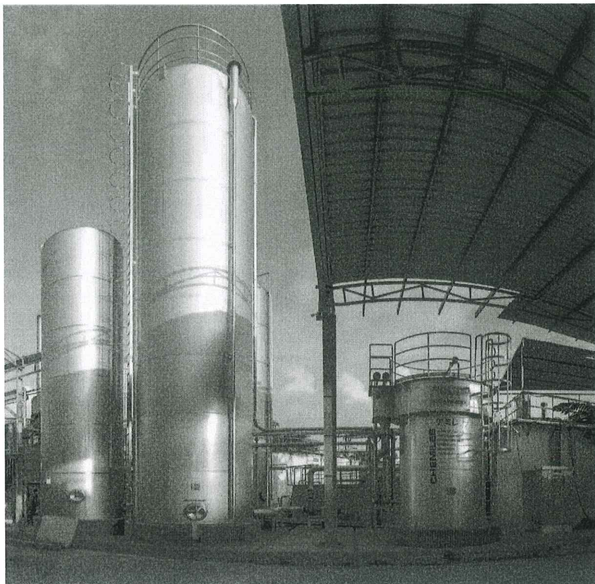
Hệ thống xử lý nước
